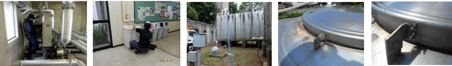
送水設備点検状況 水質検査(採水)状況 受水槽清掃状況 受水槽マンホール蓋固定金具不良状況 受水槽マンホール蓋固定金具正完了
