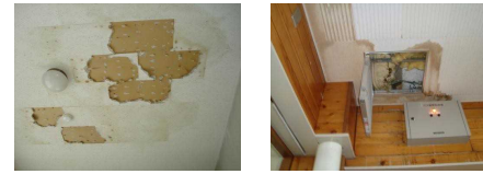
(雨漏りによる天井材剥落) (制御盤付近の雨漏り)
