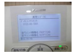
F11講義室のダイキンパッケージエアコン(空冷ヒートポンプ式)点検
