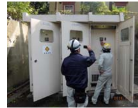
講堂與キュービクル・図書館電気室の高圧トランスの表面温度の測定
