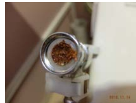
トレーニングセンター多目的トイレ給水タンクの水量が少ない修理
