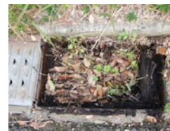
本館庁舎東キュービクル道路前の排水溝の汚泥・木の根等の除去清掃
