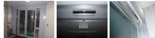
自動扉本体 自動扉感知 駆動状況
