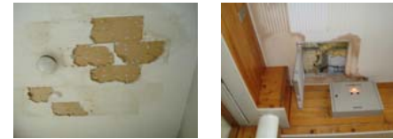
(雨漏りによる天井材剥落) (制御盤付近の雨漏り)
