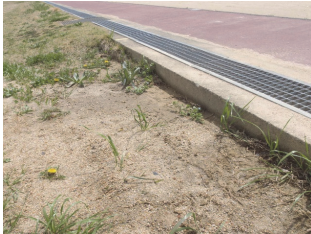
運動場内に段差ができてしまっており、つまづき等の危険要因となっている
